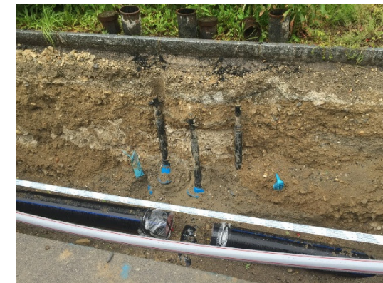
Wasserleitung IBB Energie AG
