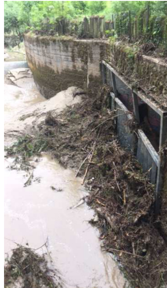
Verklauster Rechen beim Einlauf in einen Entlastungsstollen
