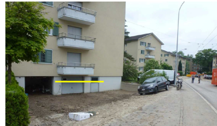
Spuren eines Hochwassers, gelbe Linie = max. Wasserstand
